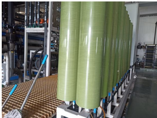
渗滤液处理站（膜处理）
