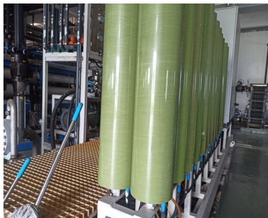
渗滤液处理站（膜处理）
