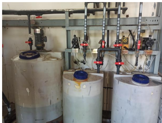
渗滤液处理站（加药）
