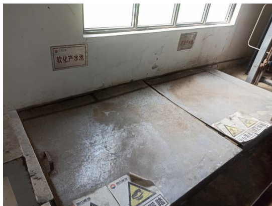
渗滤液处理站（软化+超滤）
