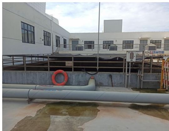
渗滤液处理站（硝化）
