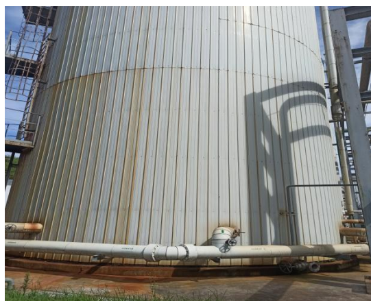
渗滤液处理站（厌氧）
