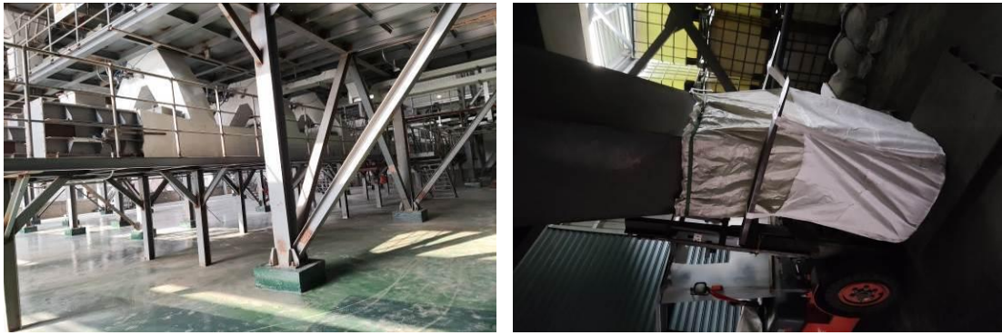
密闭的炉渣输送线
