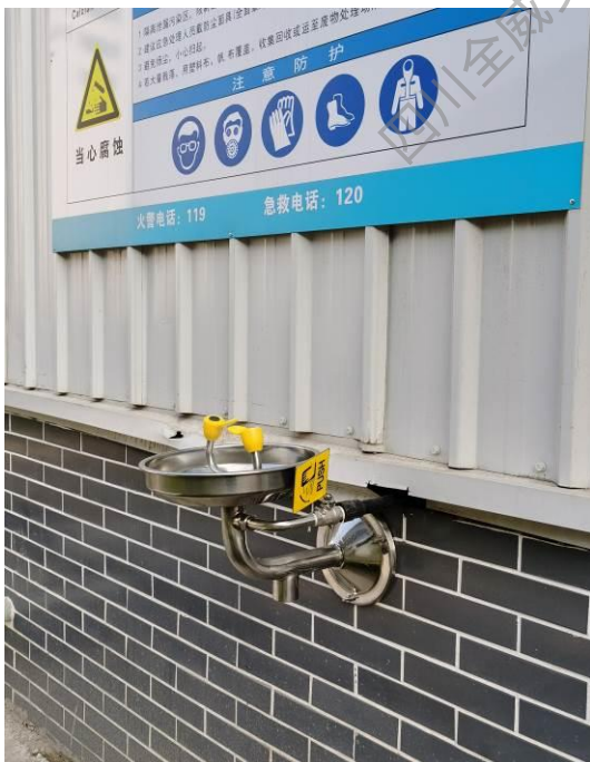
石灰石制备间喷淋洗眼器现场照片
