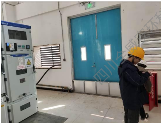
110kV 升压站通风百叶窗
