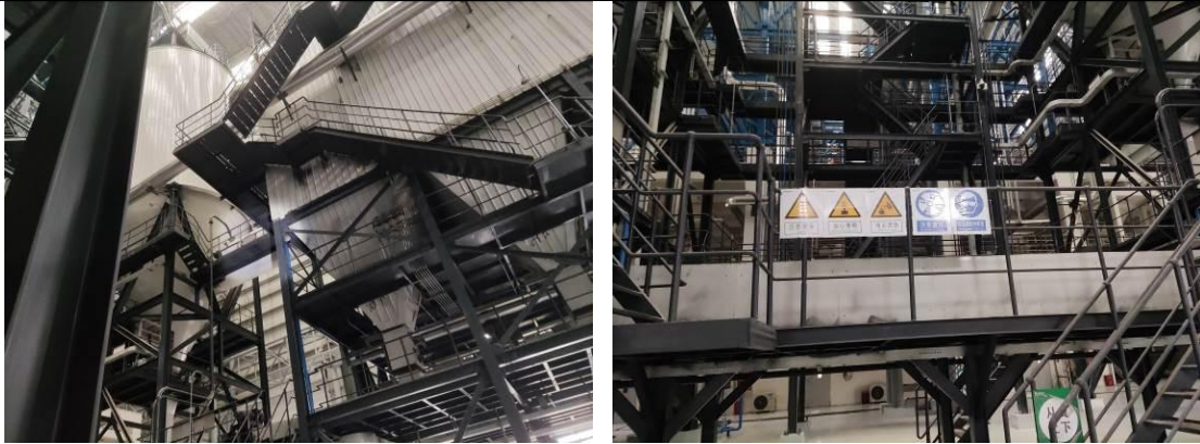
密闭、自动化的焚烧、烟气净化系统
