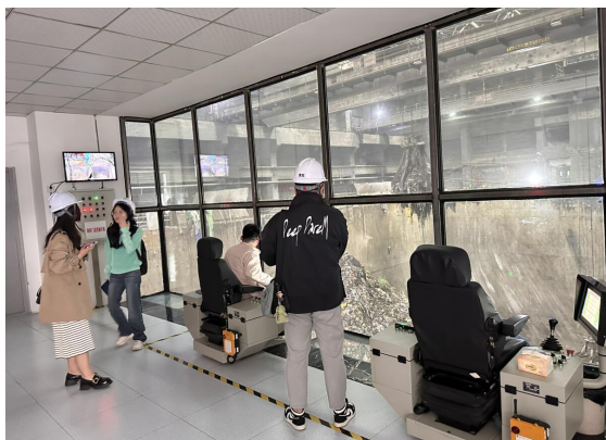
独立、阻尘垃圾吊控制室
