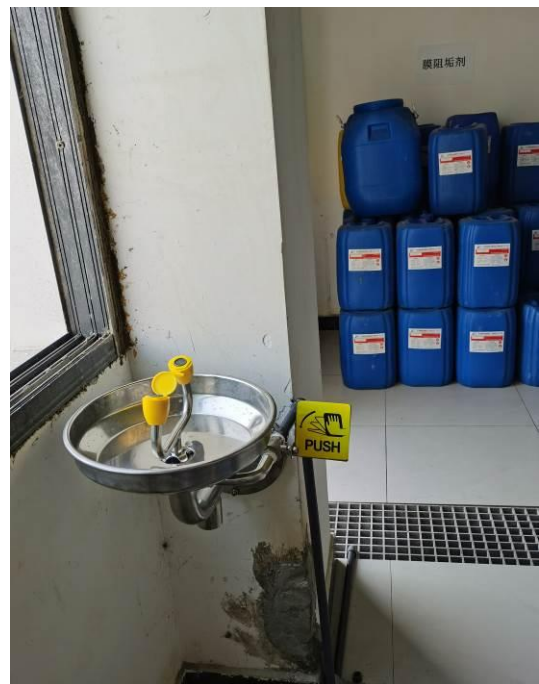
渗滤液处理加药间喷淋洗眼装置
