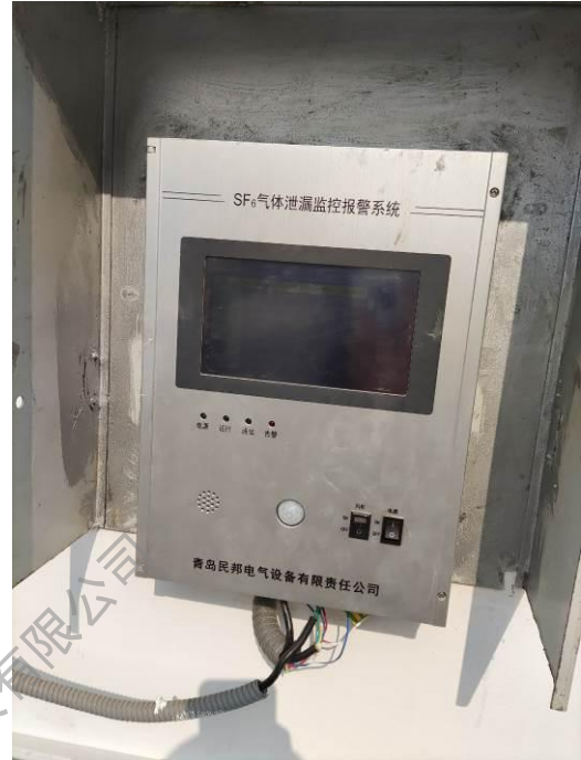
升压站 SF 6 气体探测报警器
