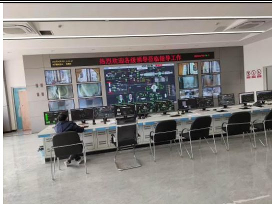
DCS集中监视和控制系统终端
