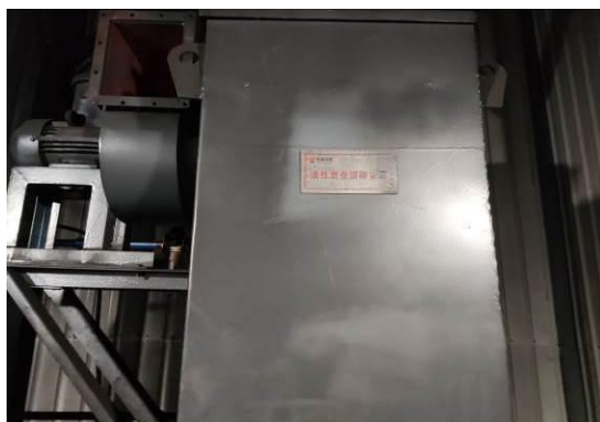
活性炭投料口除尘装置
