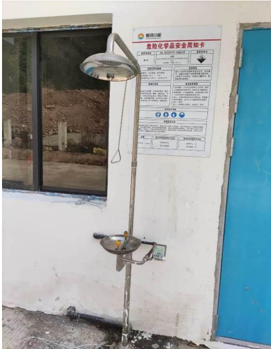
储酸间冲淋洗眼装置现场照片
