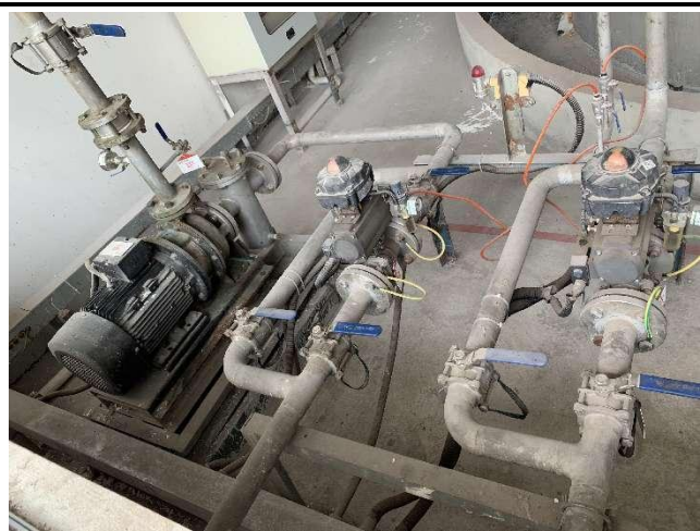
氨水输送管道及输送泵
