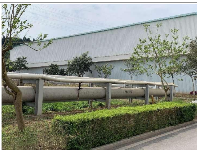
臭气回收管道
