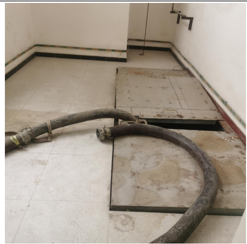
渗滤液收集池
