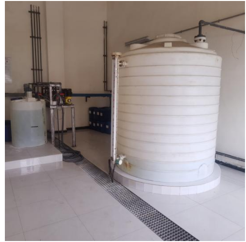
氢氧化钠储罐
