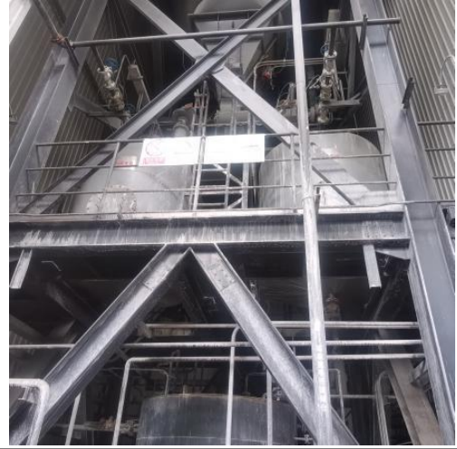
石灰浆制备罐
