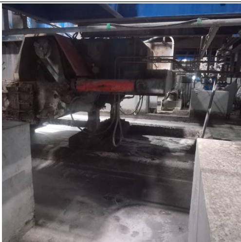
捞渣机渗滤液池
