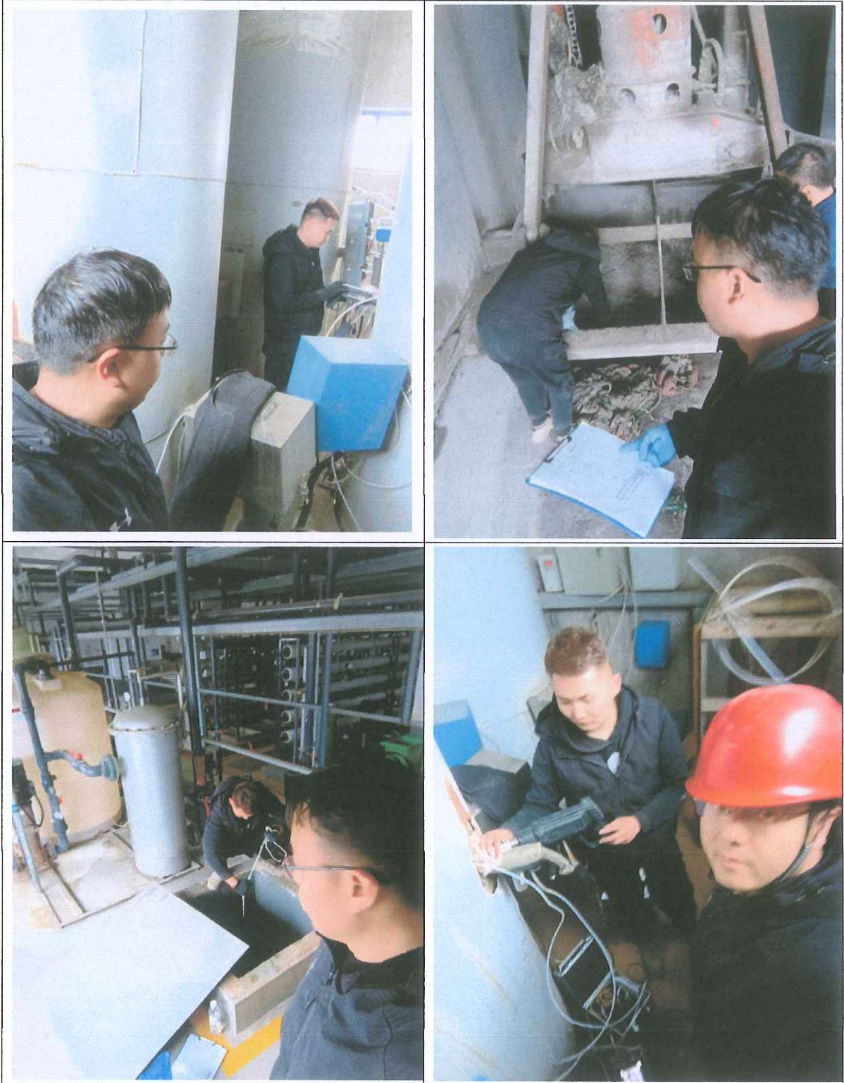
附件 2：长垣川能环保能源发电有限公司现场检测照片
