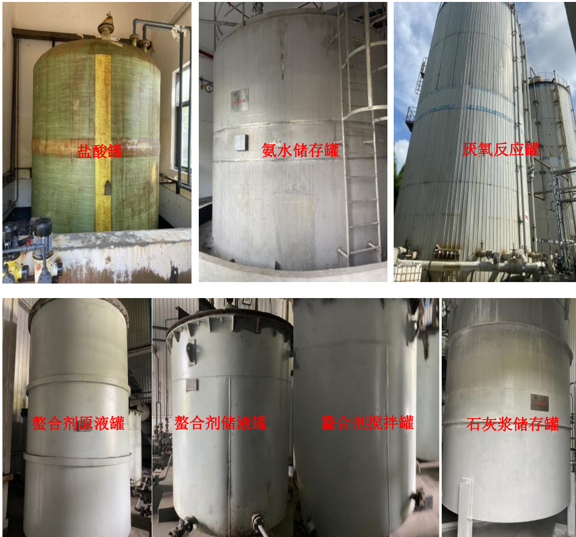
图 4-1 接地罐现场情况
